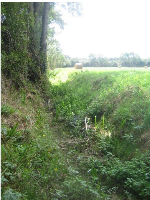
Fossé de l'exutoir dans milieu naturel
